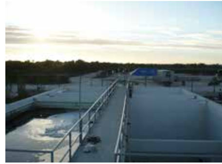
PLANTAS DE TRATAMIENTO DE AGUA
